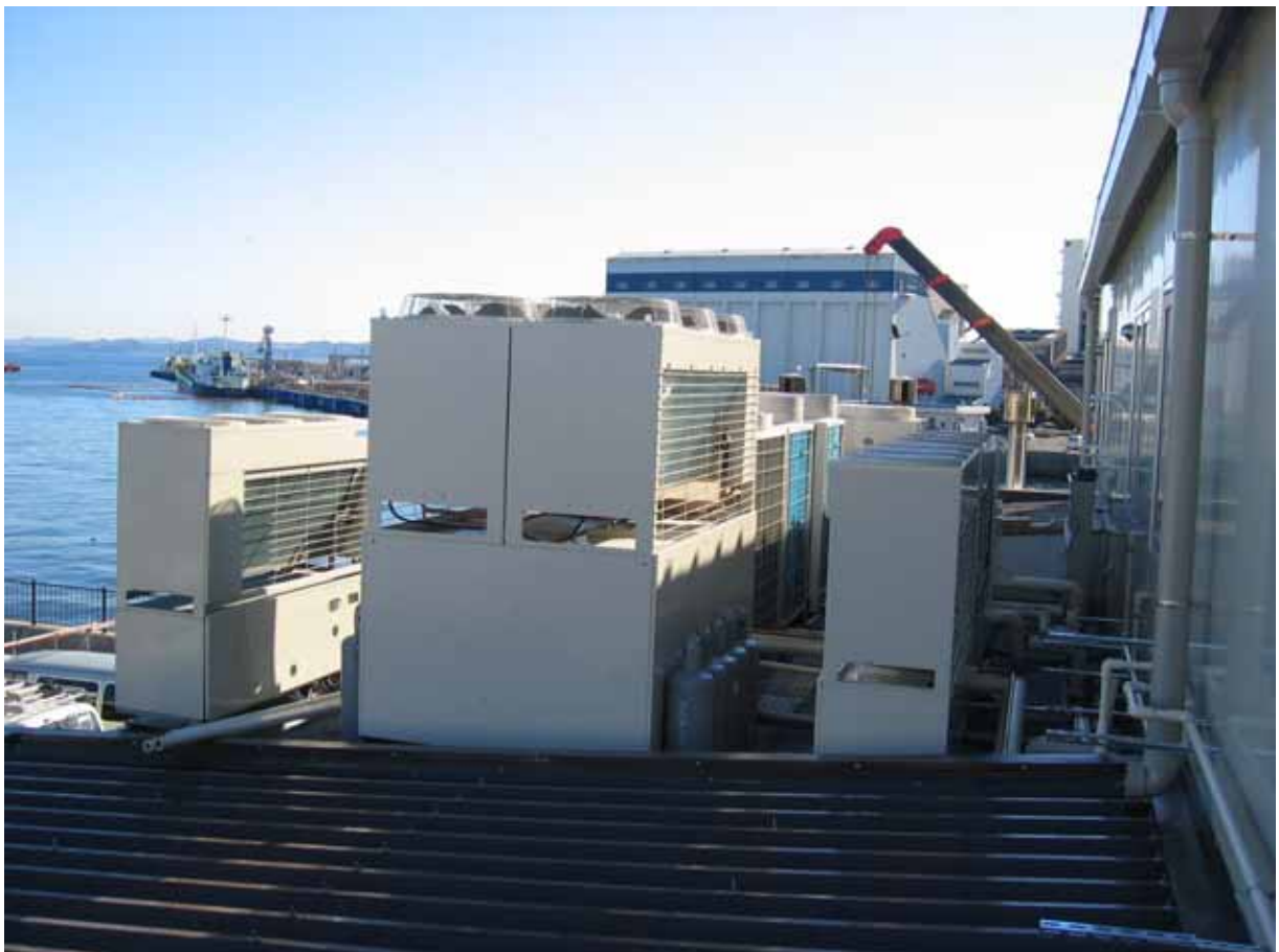
空調室外機置き場
