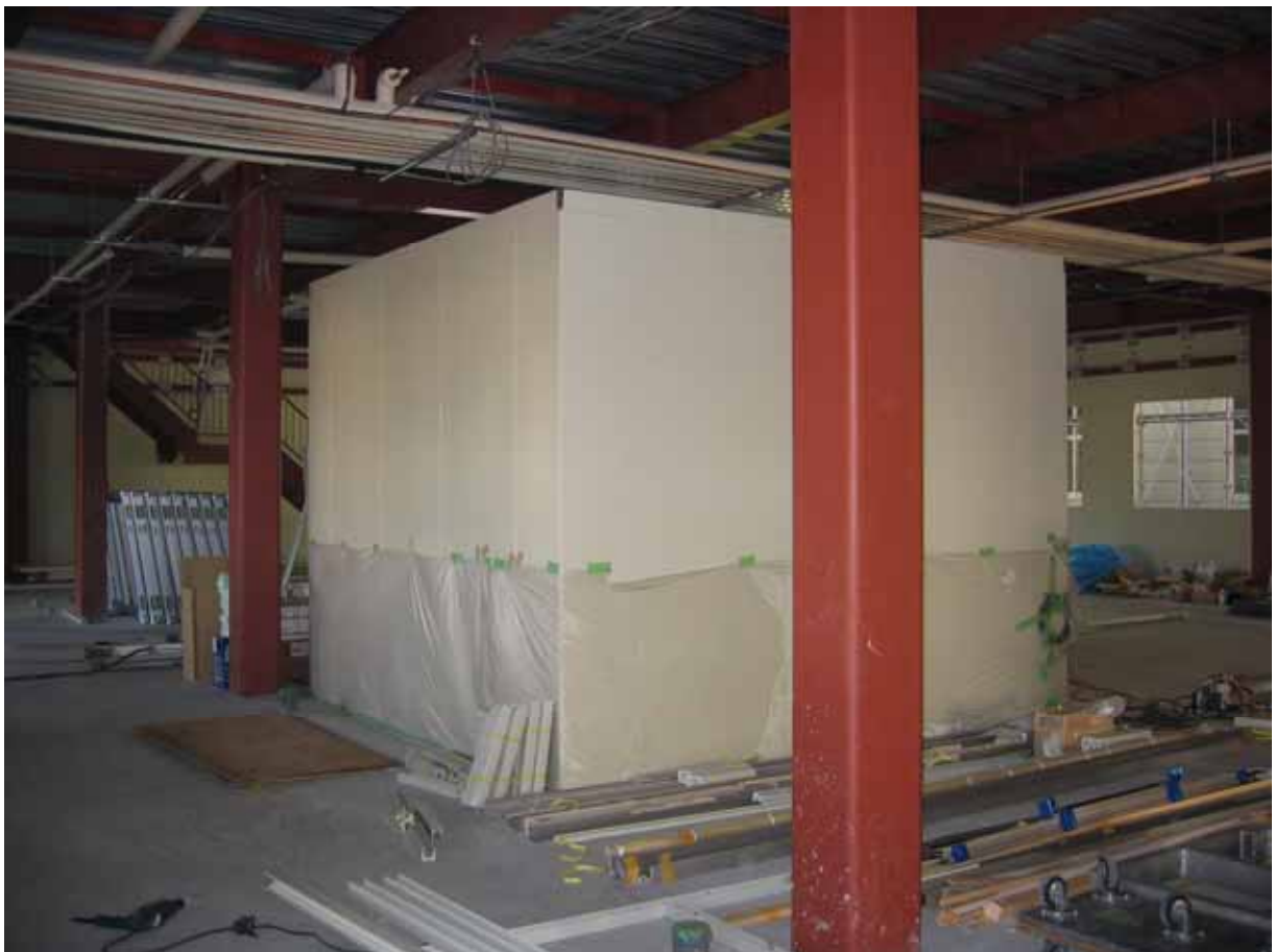
建屋内部冷凍庫 背面
