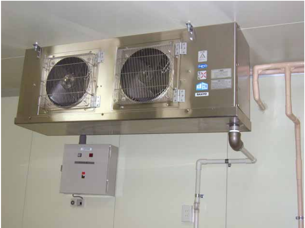
冷却器および配管納り
