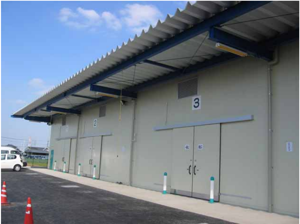
入出荷口 電動両引き扉（室外側）
